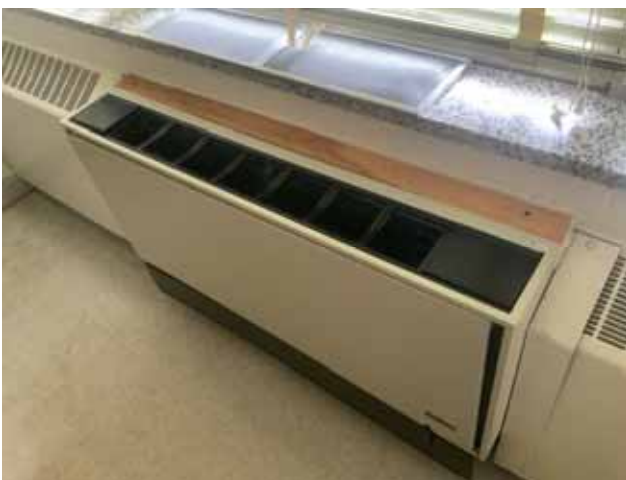
17 - FAN COIL UNIT
